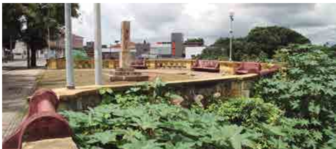
Bancos deteriorados e muros quebrados: monumento tombado em 1980 tem recebido pouca manutenção da prefeitura
